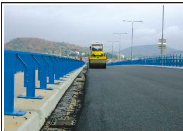
Opravy na Novém mostě skončí na konci listopadu, kdy by měl být opět otevřen provoz v obou směrech. foto: Ladislav Neuman
